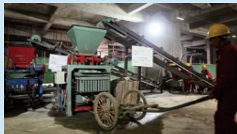
余料回收利用系统 Excess Material Recycling System
