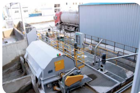
污水处理回收系统
