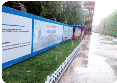
现场绿化带设置喷淋设施
